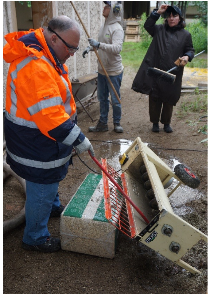
Auch der Materialversorgungswagen muss gesäubert sein indem Materialreste gut entfernt werden.
